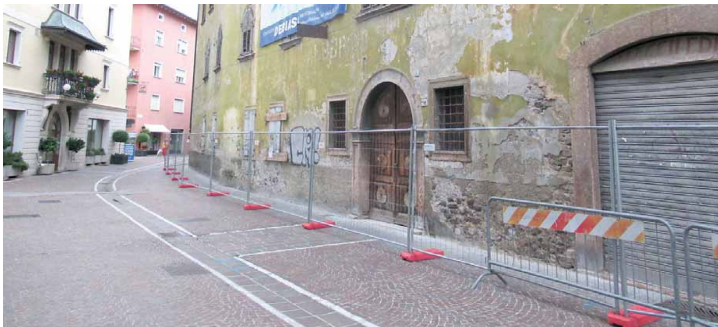
• L'ex Albergo Cavalletto di via Pennella che versa in una estrema situazione di degrado e che non vede all'orizzonte possibili soluzioni
